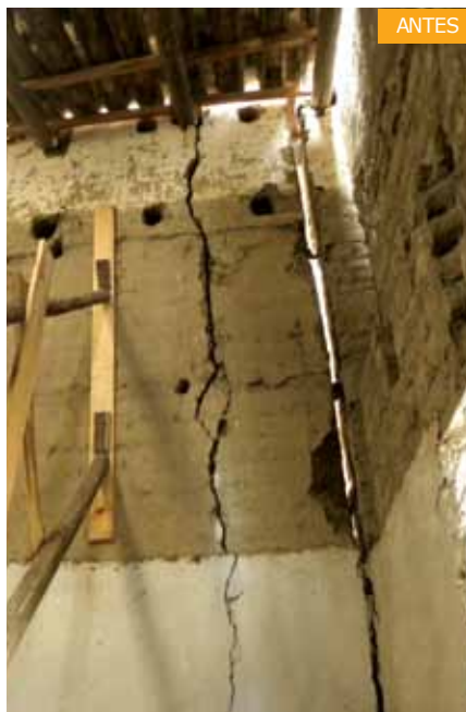
El estado de los muros era realmente crítico.
